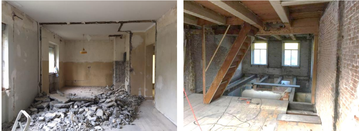
Abb. Anhang 21: Risiko bei Abbruch- und Rückbauarbeiten, bspw. durch Stolpern über Abbruchmaterial oder Abstürzen durch Bodenöffnungen (links: Piede 2017; rechts: Kess 2017)
